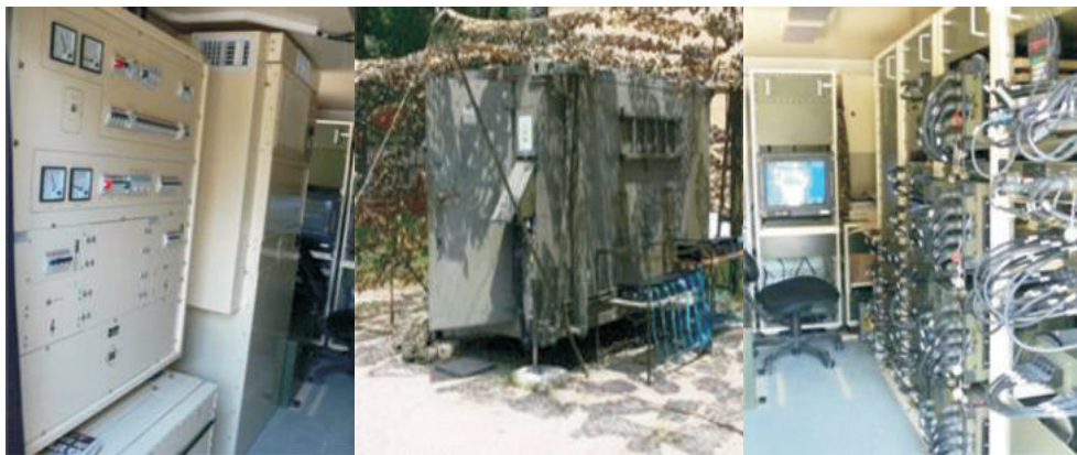
Foto 8: Container transportabil de comutație, multiplexare, supervizare și secretizare 6
